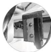
INTERRUPTOR LIMITADOR ALTURA EN ELEVADOR SECUNDARIO
